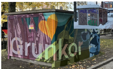
Transformatorstation med ny muralmålning
